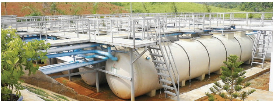
Рис. 44.6. Установки з очищення води закритого типу
