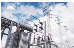
Stație de transformatoare
