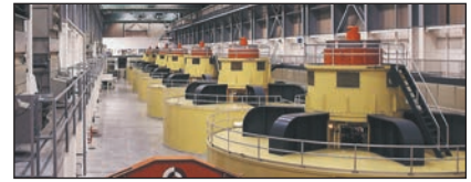
Мал. 1. Турбінний зал ГЕС. Турбіною називають двигун із лопатями, який надає руху валу генератора під тиском пари або води.
