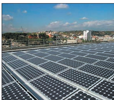
Мал. 4. Сонячна електростанція.
