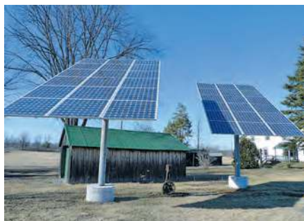
9. ábra. Magánterületen felállított félvezető napelemek
