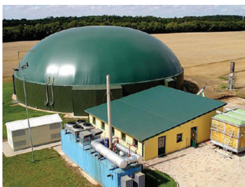
97. ábra. Biogáz-energiatermelő berendezés (Kijev megye)
